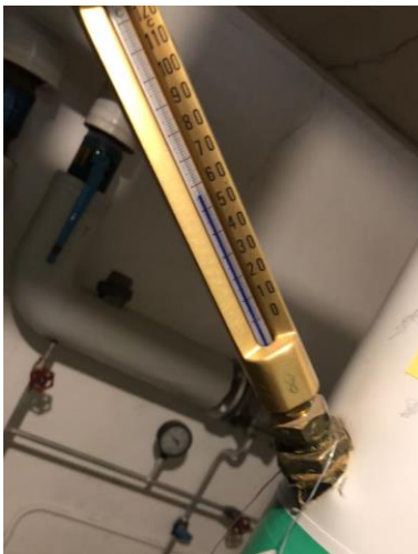
Figur 13: Termometer på varmvattensida i UC
