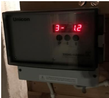
Figur 15: Reglercentral för styrning av fläkt
